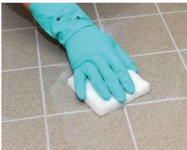
5 После высыхания остатки затирки на поверхности облицовки разжижить водой с помощью влажной полиэстеровой губки, время от времени ополаскиваемой в теплой воде с добавлением мощного средства Sopro EAH 547 .....
